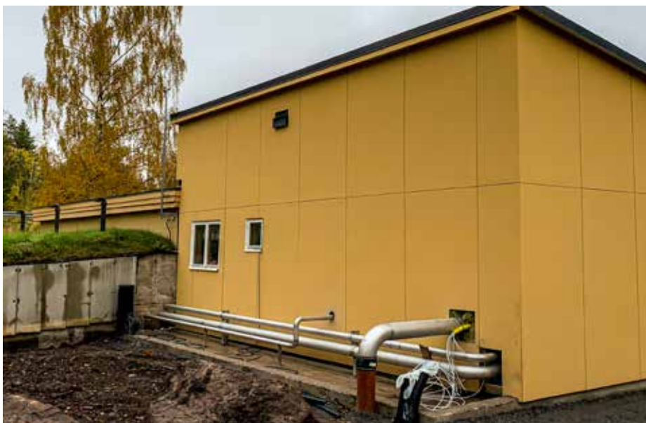
Vattenverket i Zinkgruvan har byggts ut för att höja kvaliteten på vattnet.
