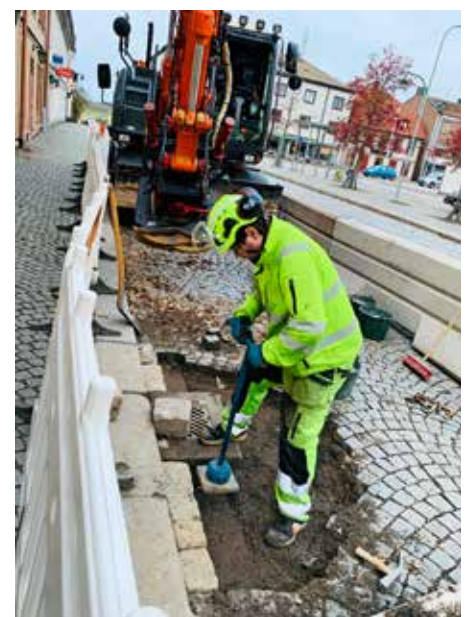
Linus Gunnarsson använder stamp för att jämna till underlaget innan gatstenarna läggs på plats.
