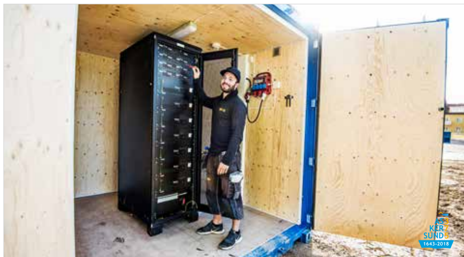
Elektrikern Niklas Karlsson i energilagret med de litiumbatterier som är en viktig del av anläggningen på Sjöängen.
