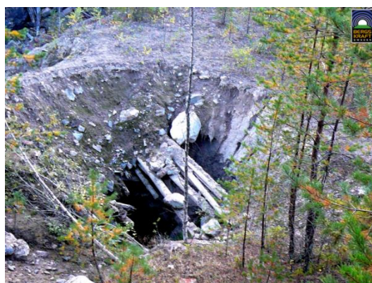
Figur 27. Ras i Kaveltorp. Tidigare schaktlock och schaktväggar har kollapsat.
